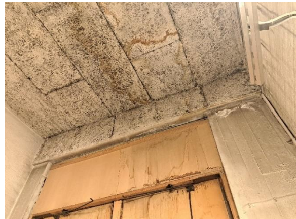
Kuva 44: Vuotojälkiä eteläosan sisäkattopinnalla.
