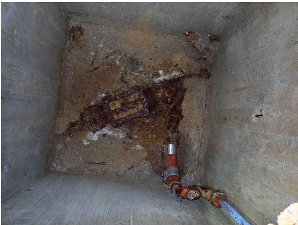
Kuva 53: Pohjaviemäri on käyttökänsä päässä.
