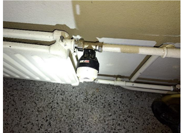
Kuva 52: Patteriventtiili ja termostaatti 1980-luvulta.
