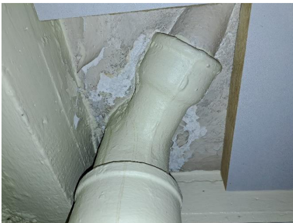
Kuva 21: Todennäköinen viemärivuoto läpiviennin kohdalla.
