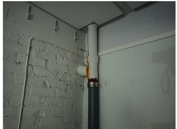
Kuva 54: Uusittua ja vanhaa viemäriputkea. Havaittavissa vuotojälkiä.
