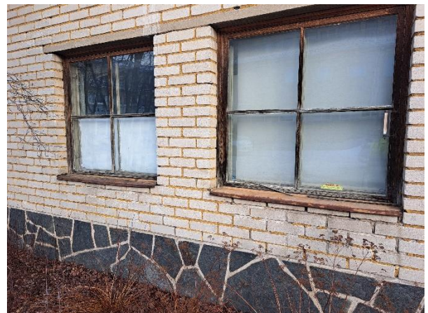
Kuva 26: Pellitykset ovat ruostuneita ja kaatoja ei ole.
