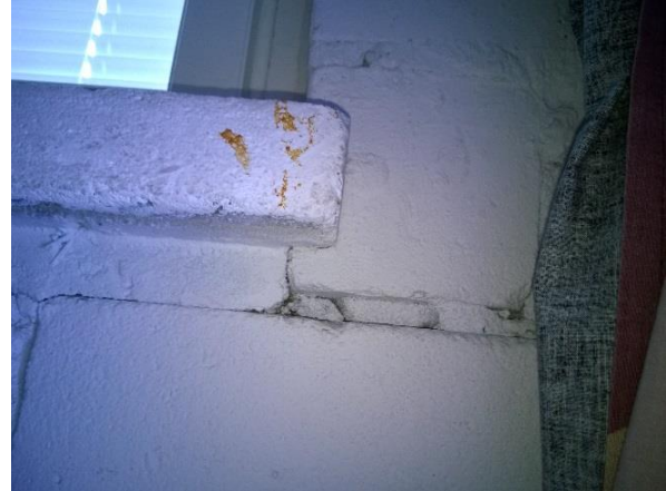
Kuva 32: Selvää vuotoa esiintyi myös ulkoseinän ja ikkunoiden liitoskohdilla.
