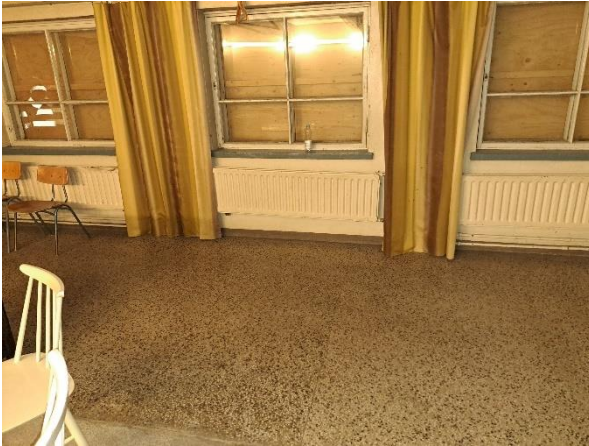
Kuva 51: Tiloissa olevat radiaattorit ovat pääasiassa 1980-luvulta.
