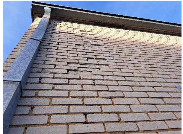
Kuva 24: Tiilijulkisivu on vaurioitunut.
