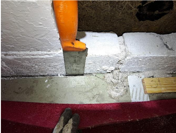
Kuva 15: Ulkoseinärakenteen ja alapohjan liitoskohta on epätiivis.
