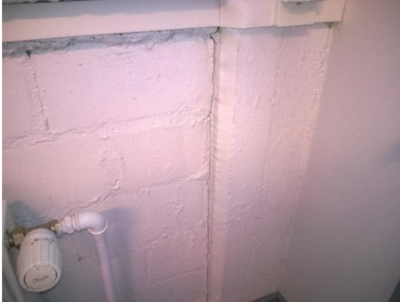
Kuva 31: Ilmavuotoreittejä havaittiin muurausten ja pilareiden liittymissä.
