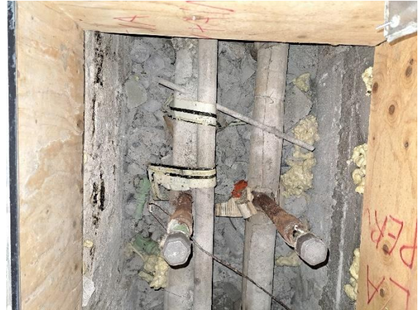
Kuva 48: Kanaalissa lämmitysputket ja lämpimän käyttöveden putki.
