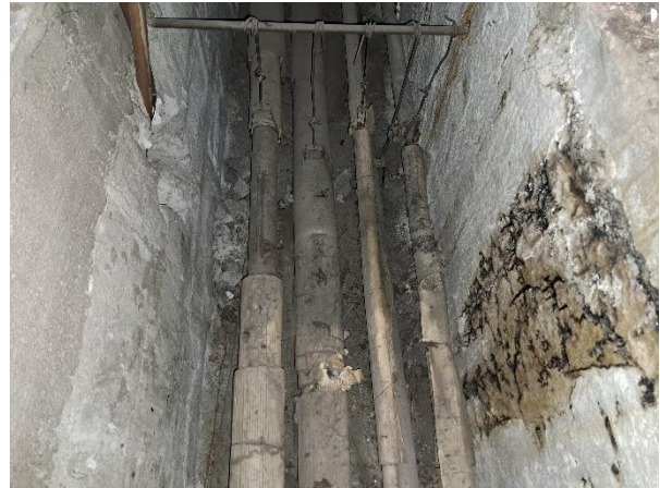
Kuva 50: Kanaalissa lämpimän veden kierto, 2 x lämmitysputki, lämpimän veden putki sekä ilman eristettä oleva rautaputki.
