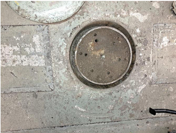
Kuva 10: Lattiarakenteessa oleva nostin.
