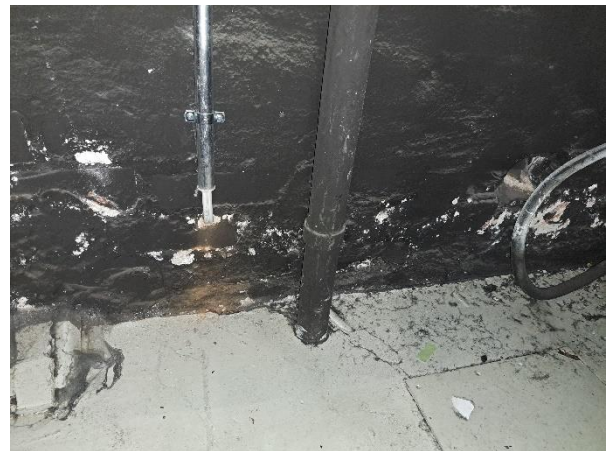
Kuva 34: Tilassa 101 väliseinän alaosassa kosteusvaurioita.
