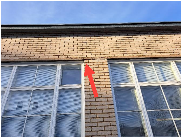
Kuva 23: Ikkunoiden ylityspalkki on vaurioitunut.
