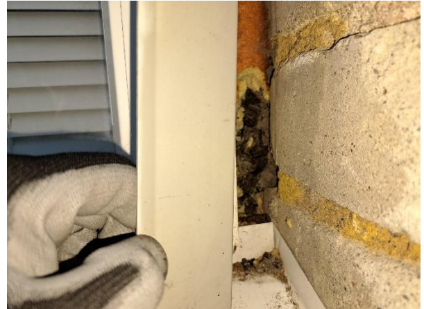
Kuva 28: Uusitun ikkunan seinärakenteeseen on jätetty rive-eristeet.
