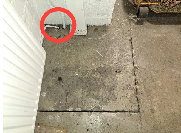
Kuva 16: Länsipuolen putkikanaalin betoniluukku ja putkiläpiviennit ovat epätiivitä.
