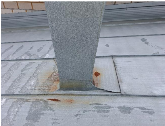
Kuva 39: Vesikatteessa havaittiin ruostumista.
