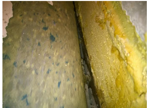
Kuva 18: Ulkoseinärakenteen ja alapohjan liitoskohta on epätiivis.
