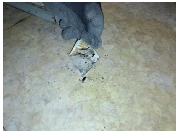
Kuva 22: Muovimattopinnoitteen alla mustaa liimaa.
