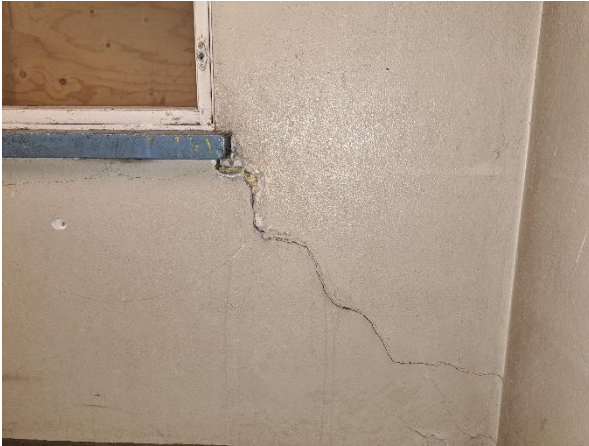
Kuva 27: Halkeamaa sisäpuolisessa tiilimuurauksessa.
