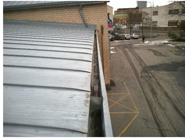
Kuva 38: Pohjoisosan sadevedet laskevat eteläosan vesikatolle. Räystäskourut ovat heikossa kunnossa.
